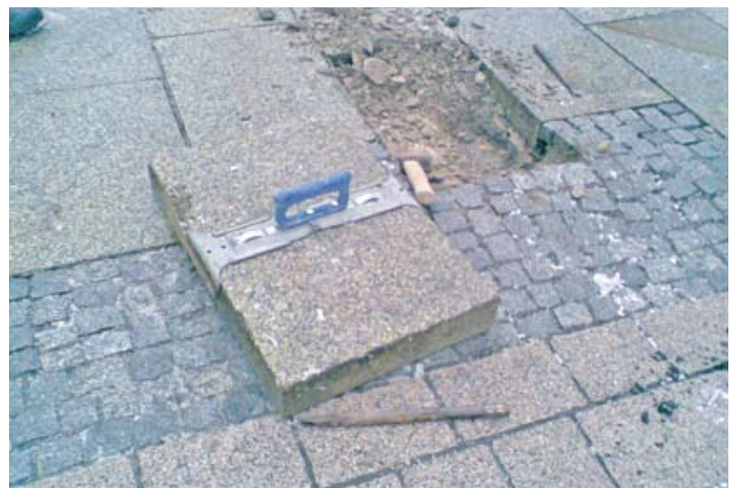
Reparaturanfällig: fast täglich muss zur Zeit der Plattenbelag in der Fußgängerzone ausgebessert werden
